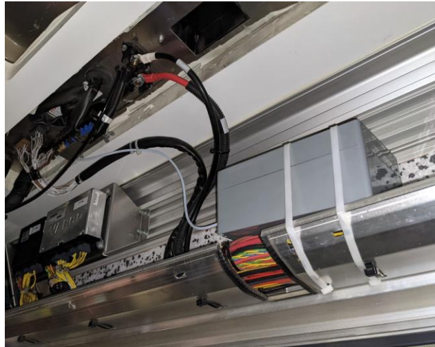
Abbildung 26: Befestigung des Sensors im Elektronik-Regal des Busses sowie Verlegung der Kabel zur Sicherungsbox sowie zum Dach (Lufteinlass)
